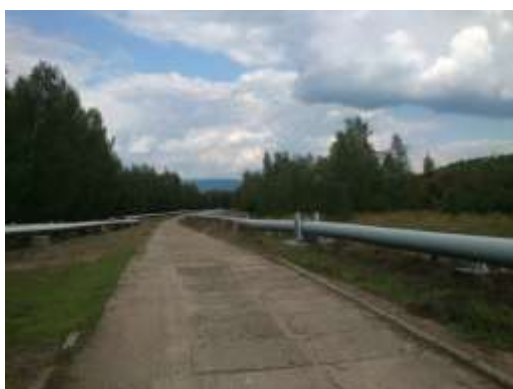
Obrázek 4 - Nadzemní trasa produktovodů s obslužnou komunikací na Hořanské výsypce
